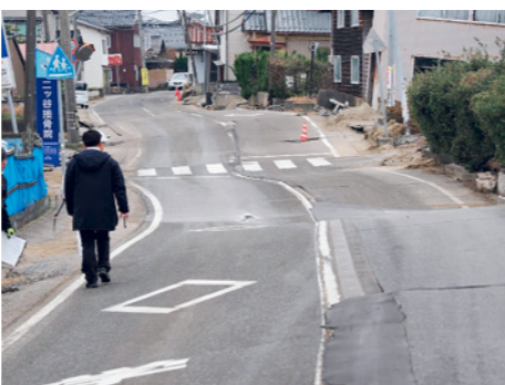
図-4 2024年能登半島地震による内灘町の道路の波打ち。右が滑りの上流側、道路の右側が盛り上がっているが、一様ではなく結果として波打っている。
