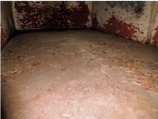
千代ヶ崎砲台の掩蔽棲息部の床に見られる隆起による亀裂
